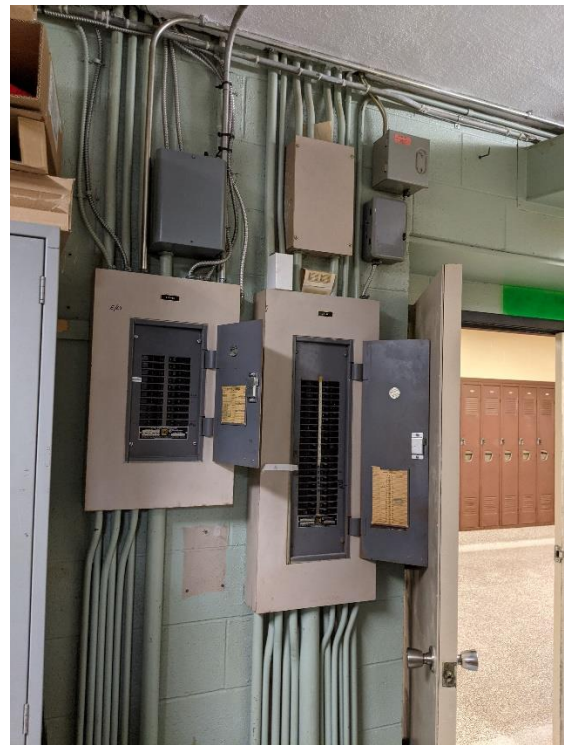
PANELS LP-2E LP-5E
